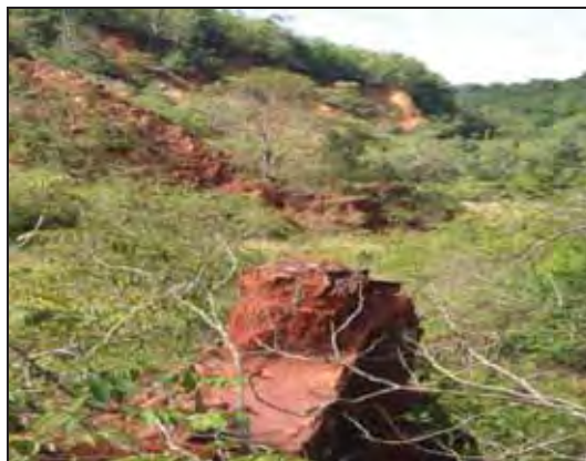
Figura 43 – Erosão em pedestal no interior da voçoroca de Costa Rica (MS).
